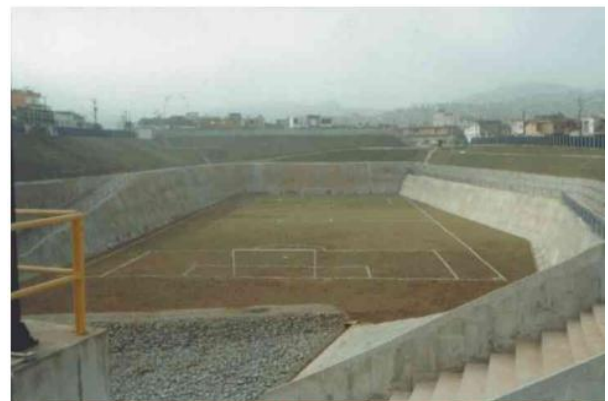
Figure 12. Detention basin in São Bernardo do Campo.
