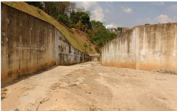
Figure 4. Detention basin of Córrego Engenho Nogueira.
