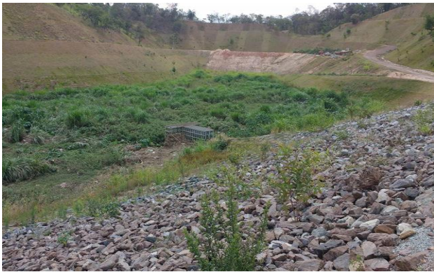
Figure 3. Detention basin of Córrego Engenho Nogueira.
